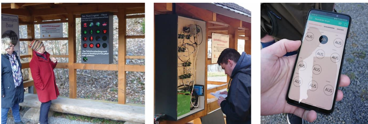
Abbildung 50: Ampel Vorderseite aus Schiefer, Innenleben der Schaltzentrale und die Steuerung über das Smartphone
