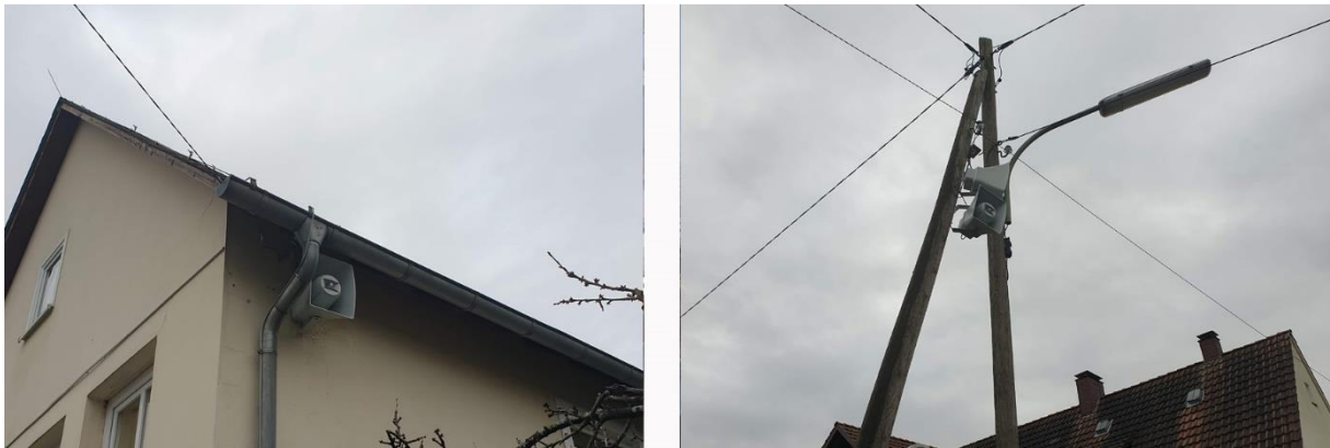
Abbildung 33: Rufanlage Niederlaasphe mit zwei von rund 20 Lautsprechern
